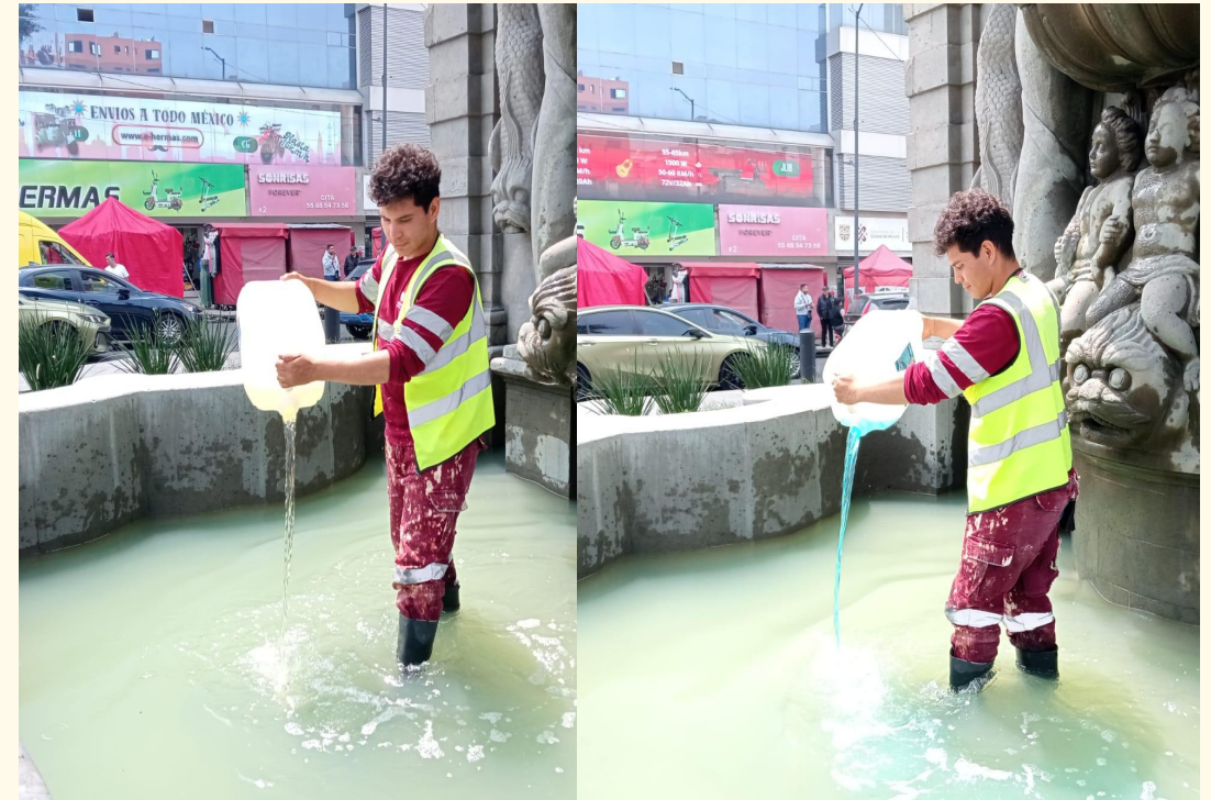
APLICACIÓN DE QUÍMICOS; HIPOCLORITO, CLARIFICADOR Y ALGUICIDA.
