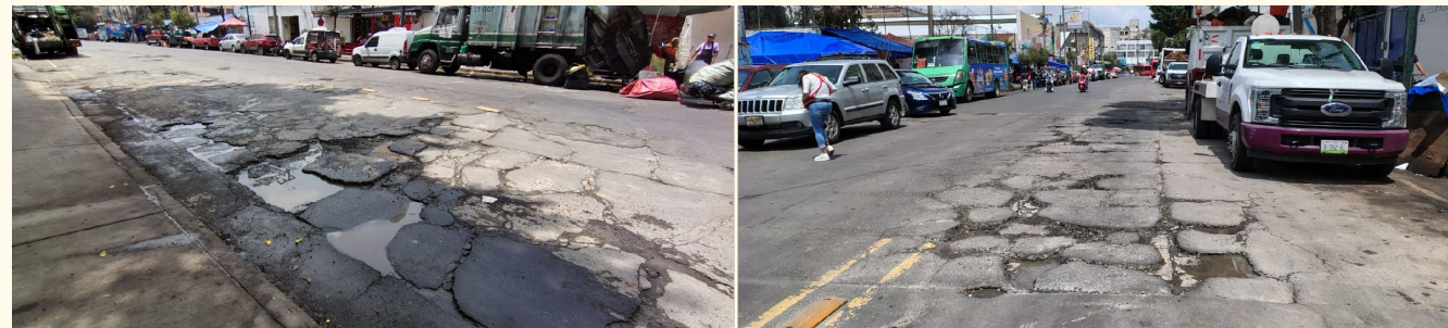
ESTADO ACTUAL DE LOSA DE RODAMIENTO EN TRAMO DE FRAY SERVANDO A SAN PABLO SOBRE COLEGIO MÉDICO MILITAR
