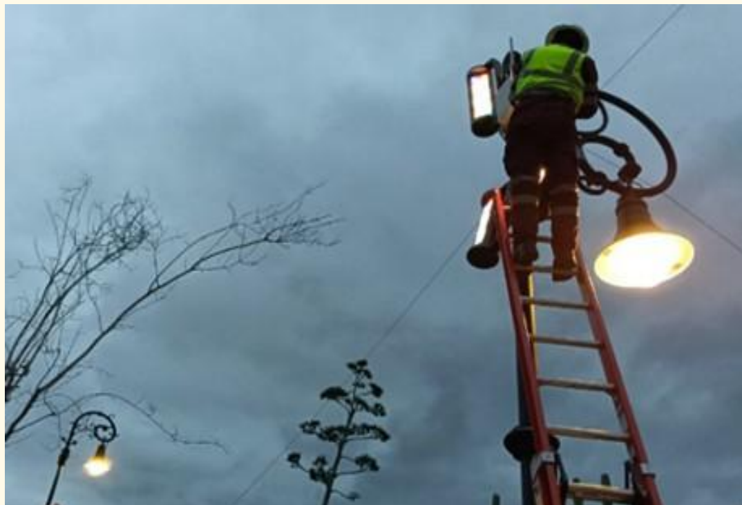
DAÑO EN EQUIPO ELÉCTRICO
