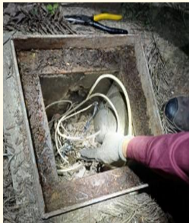
RECONEXIÓN DE LÍNEAS DE ALIMENTACIÓN
