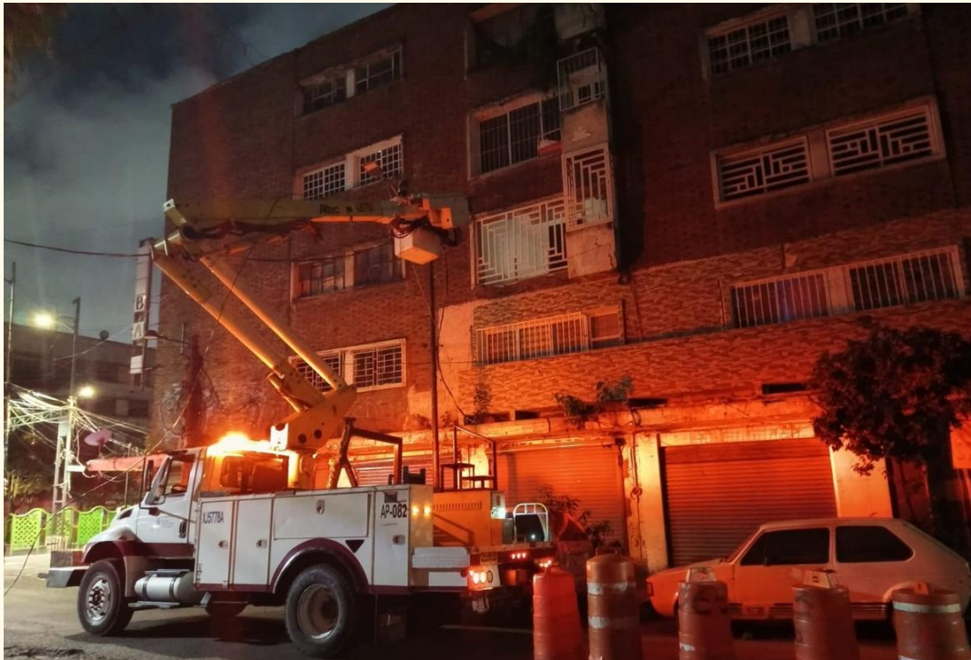
RECONEXIÓN DE LÍNEAS DE ALIMENTACIÓN
