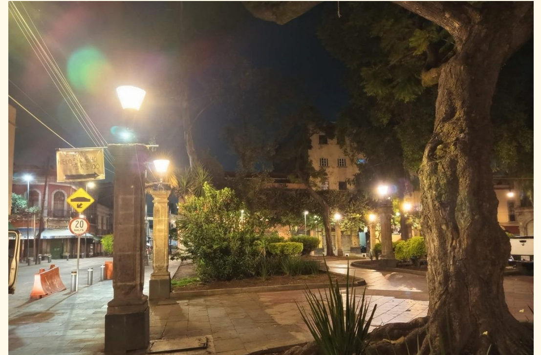
RECONEXIÓN DE LÍNEAS DE ALIMENTACIÓN
